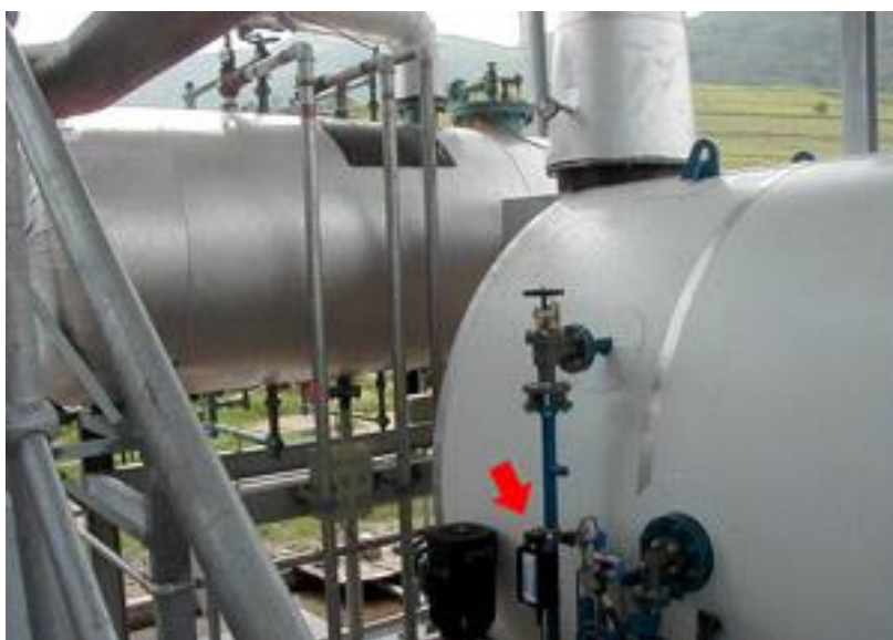
HydroFLOW S na kotle o wydajności 8t pary/h
