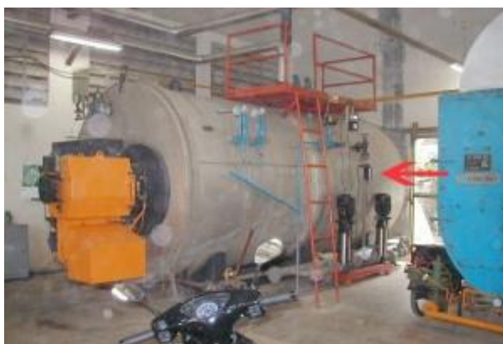
HydroFLOW S na kotle o wydajności 10t pary/h
