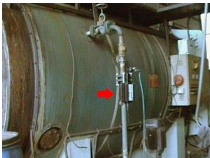
HydroFLOW S na kotle o wydajności 6t pary/h
