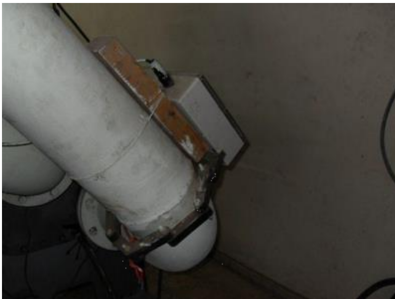
Zdjęcie przedstawia zamontowane urządzenie AquaKLEAR
