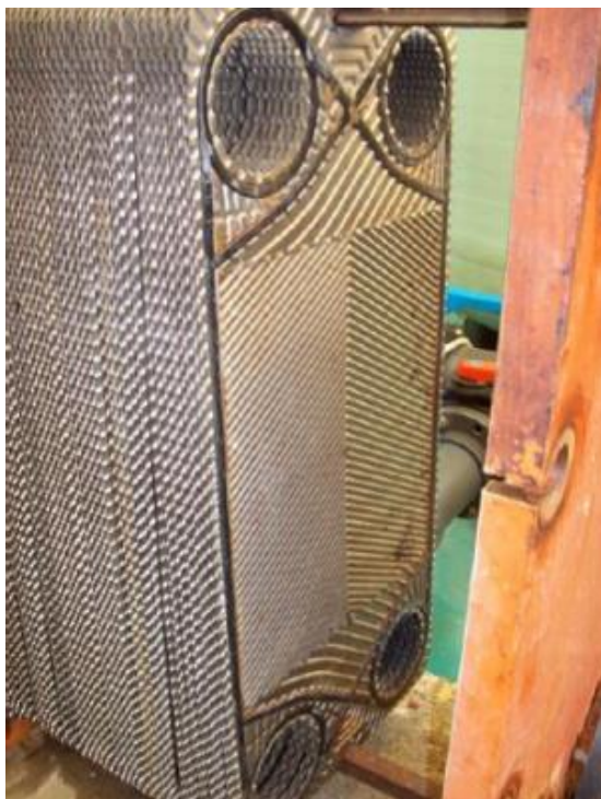
Wymiennik ciepła bez osadów, zabezpieczony urządzeniem AgriFLOW.
