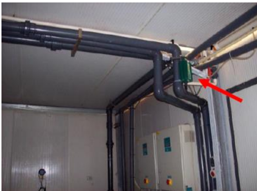
Zdjęcie przedstawia miejsce montażu urządzenia HydroFLOW AgriFLOW.
