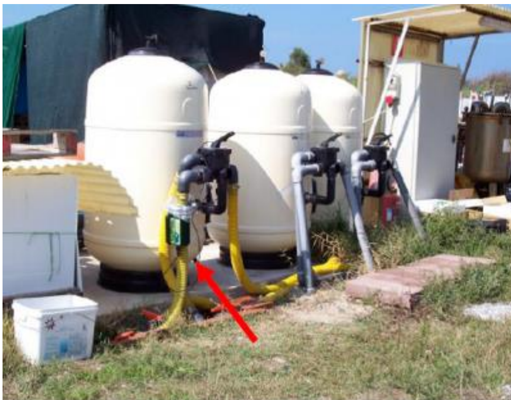
Zdjęcie przedstawia zewnętrzne zbiorniki do magazynowania wody. Również tutaj zastąpiono lampy UV urządzeniem HydroFLOW AgriFLOW.
