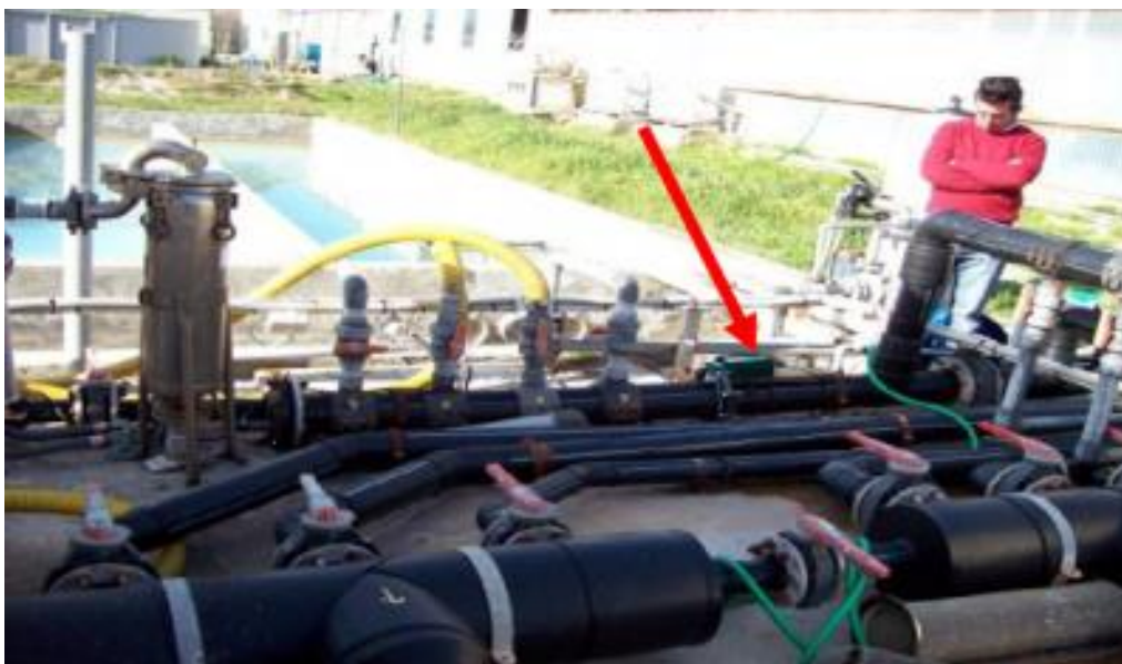
Urządzenie HydroFLOW zamontowano na rurze zasilającej cały obiekt.
