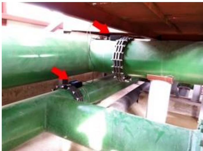
fot.3 Urządzenia HydroFLOW CUSTOM zabudowane na kolektorach
