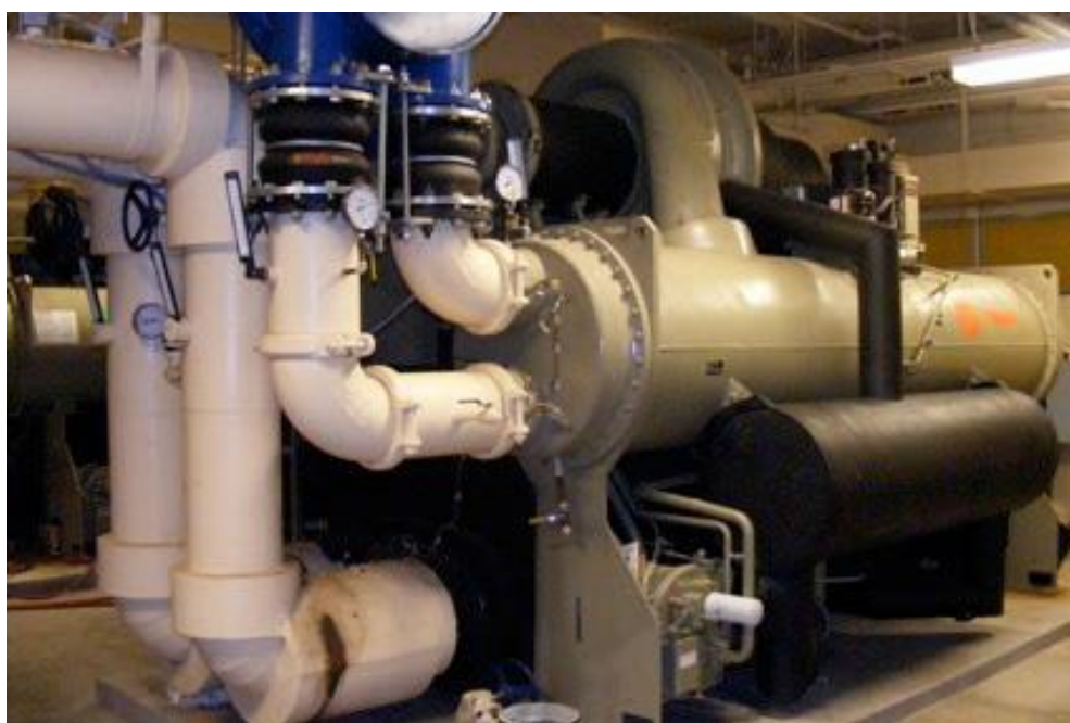
Jeden z 3 schładzaczy (chiller)
