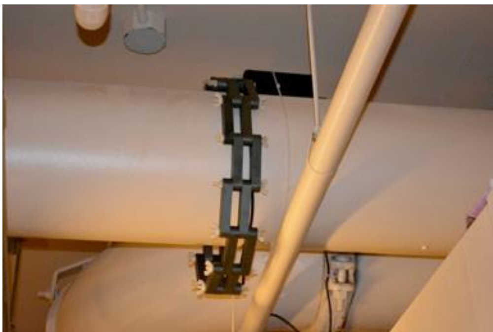
Miejsce instalacji HydroFLOW
