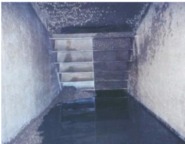
Stacja uzdatniania wody w elektrowni. Ściana po lewej stronie została oczyszczona z Racicznicy.
