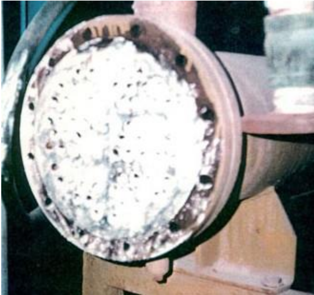
Stan wymiennika ciepła na początku testu
