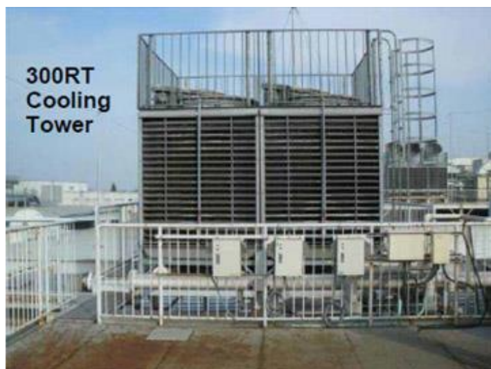
Wieża chłodnicza jest zainstalowana na dachu budynku
